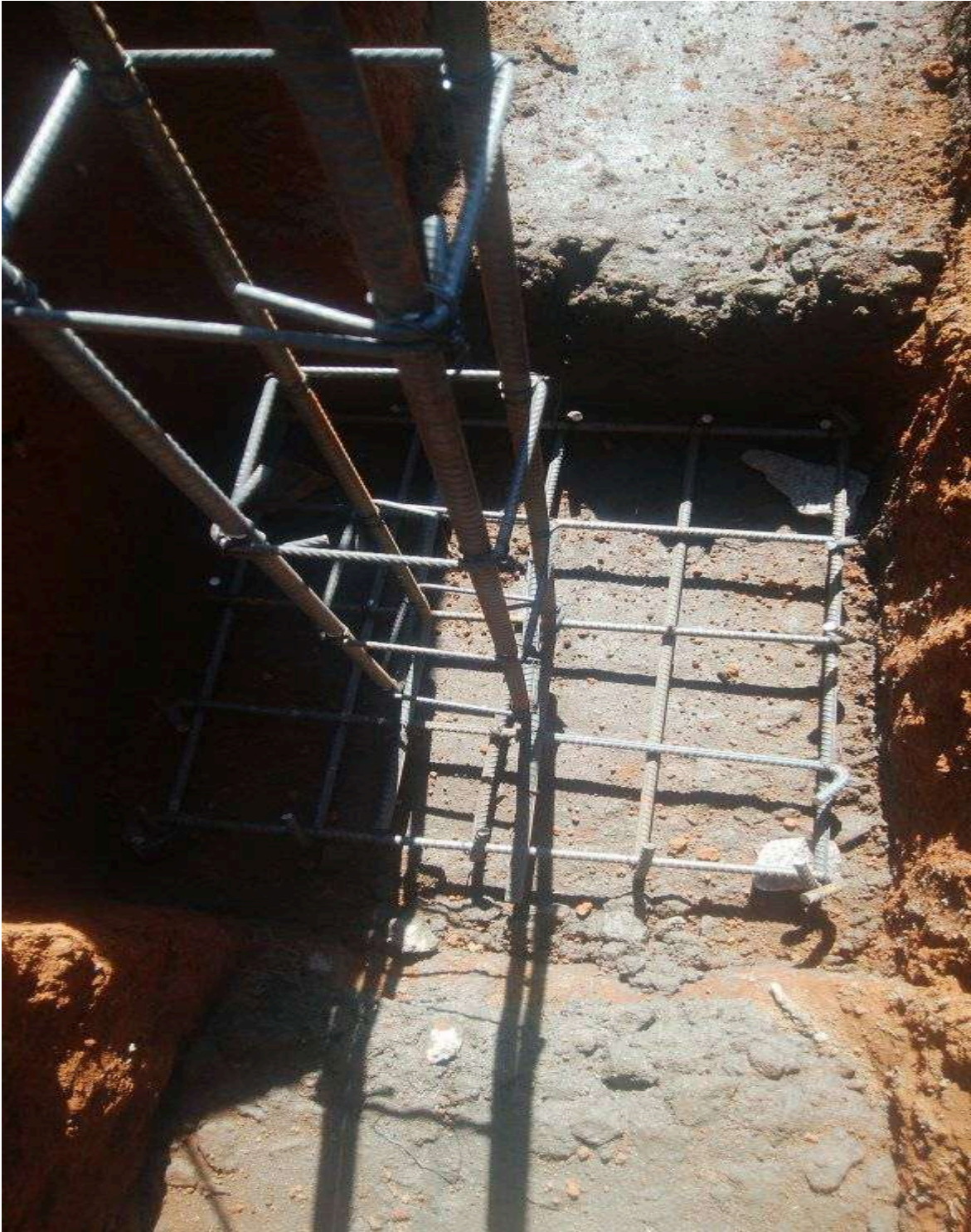
Fouille des fondations de l'école après la messe en présence du curé, des sœurs trinitaires et certains villageois
